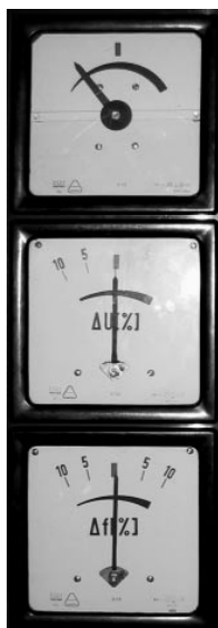
Rys.1. Typowa kolumna synchronizacyjna: najwyższy wskaźnik – synchronoskop, poniżej – wskaźnik różnicy wartości napięć, najniżej – wskaźnik różnicy częstotliwości napięć generatora i systemu
